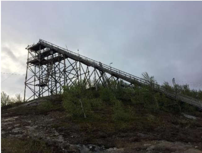
Sør-Varanger hadde fem hoppbakker i 2005. I dag er alle forfalt og ute av drift. Foto: Sør-Varanger kommune
